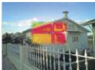
FIGURA 2: Pontes térmicas planas identificadas através de termografia.
