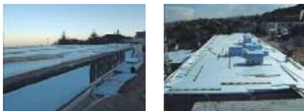
FIGURA 6: Exemplo de cobertura invertida, na fase de aplicação do isolamento térmico do tipo XPS.
